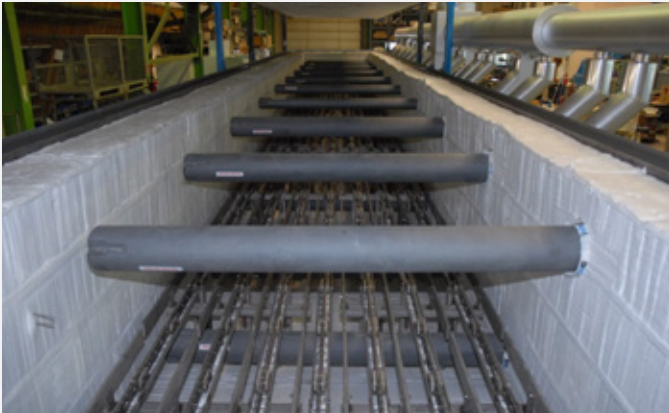
Bild 1: Hubschrittfördertechnik im Ofenbau [15]
