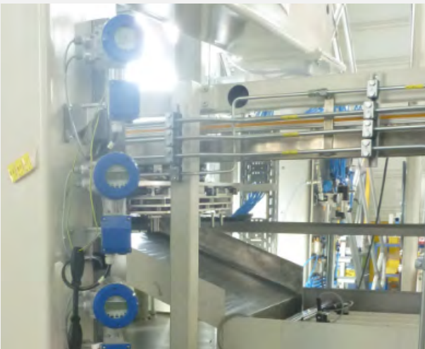
Bild 8: Volumenstrommessung Rücklauf Abschreckmedium
