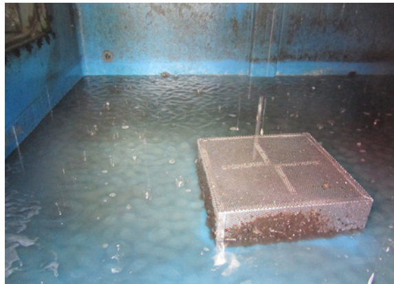
Bild 2: Schmutzablagerungen in der Kühlturmtasse, insbesondere am Ablaufsieb
